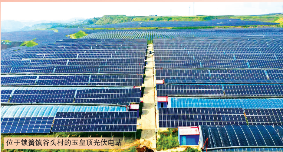
位于锁簧镇谷头村的玉皇顶光伏电站
