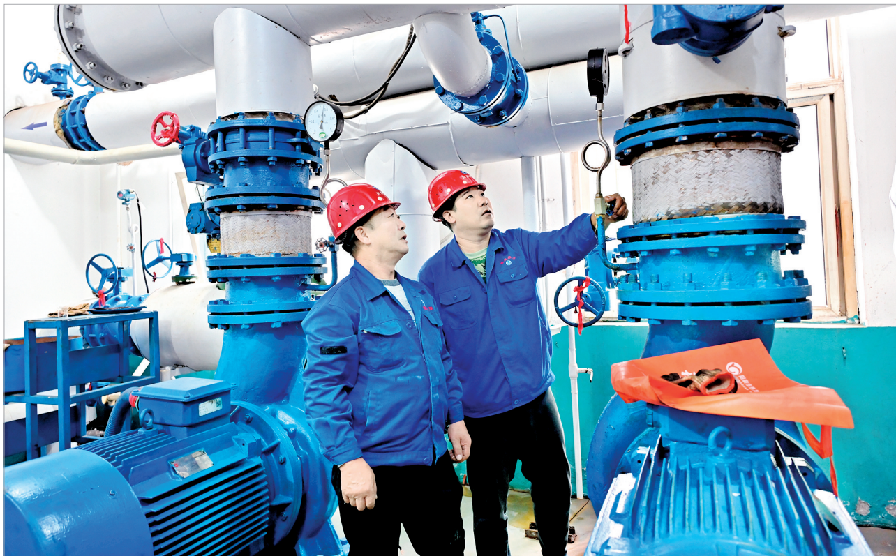
为切实保障冬季供暖工作安全稳定运行,连日来,市热力公司紧张有序地开展设备检修、调试等工作,扎实做好供热准备工作。图为10月16日,热力公司工作人员在市热力公司滨河供热服务站检查设备。 晋向华摄
