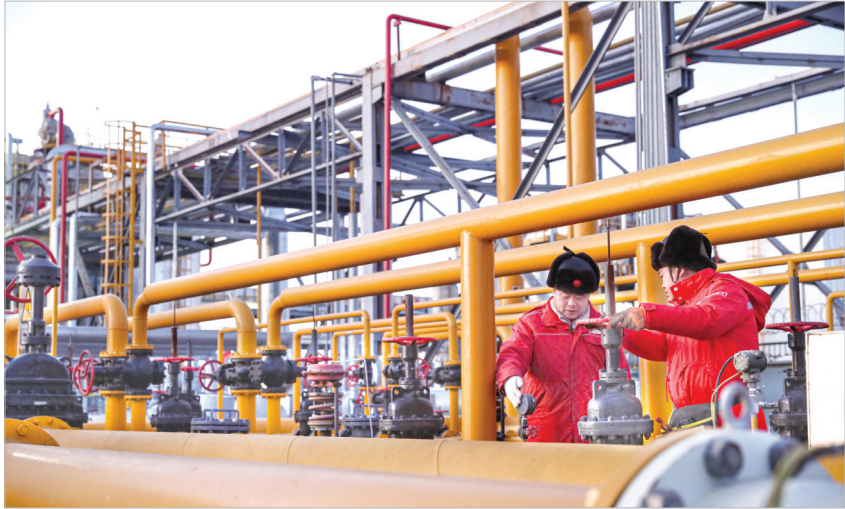
1月3日,大庆油田天然气分公司职工在对管线关键部位进行巡检。记者1月3日从中国石油大庆油田获悉,大庆油田2024年天然气产量突破60亿立方米,同比增产1.55亿立方米,实现连续14年稳定增长。 新华社发(马 克摄)
