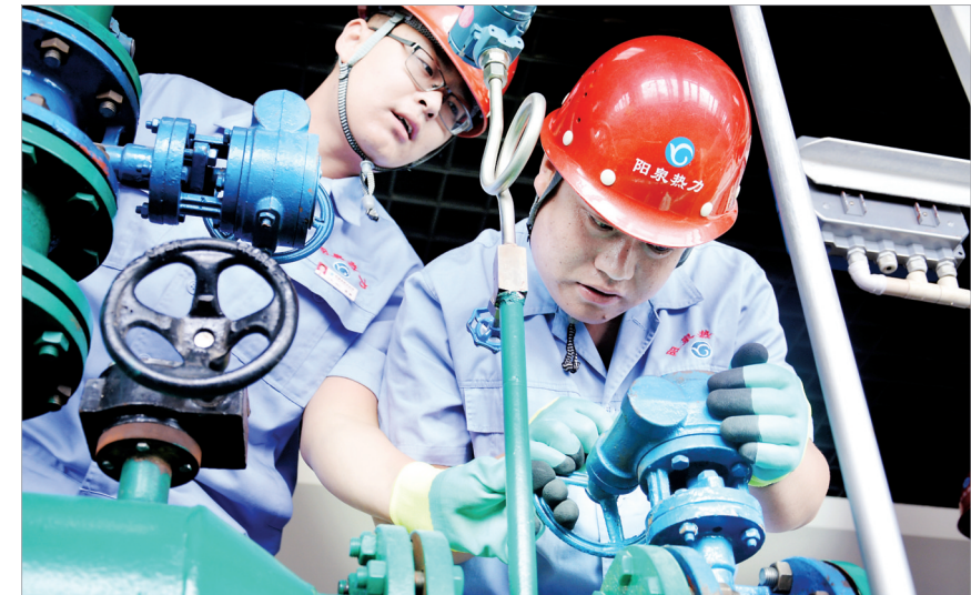
市熱力公司工人在熱力實訓基地調試設備。
