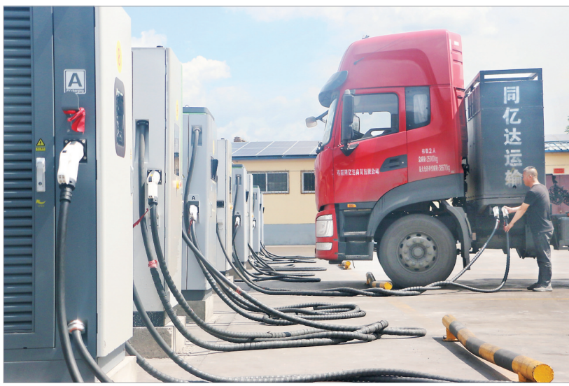
位于国道307复线矿区沙坪街道合新村段东侧的山西思特瑞新能源技术有限公司充电站及光伏发电项目于去年7月投运。该项目占地1万余平方米,建设有7个320kW直流充电桩、2座电动重卡换电站,同时利用2500平方米屋顶安装了分布式光伏发电设备,目前运行良好。未来,公司计划进一步扩大光伏发电规模,增设储能柜,实现能源高效利用。图为日前,货运司机在充电站内为车辆充电。 贺海摄
