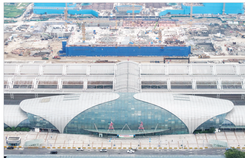
这是8月6日拍摄的新建上海至南京至合肥高铁南通站站房建设现场(无人机照片)。
