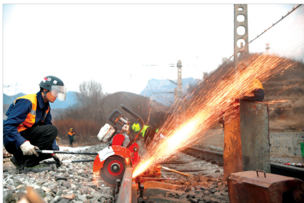
▲整修设备病害
