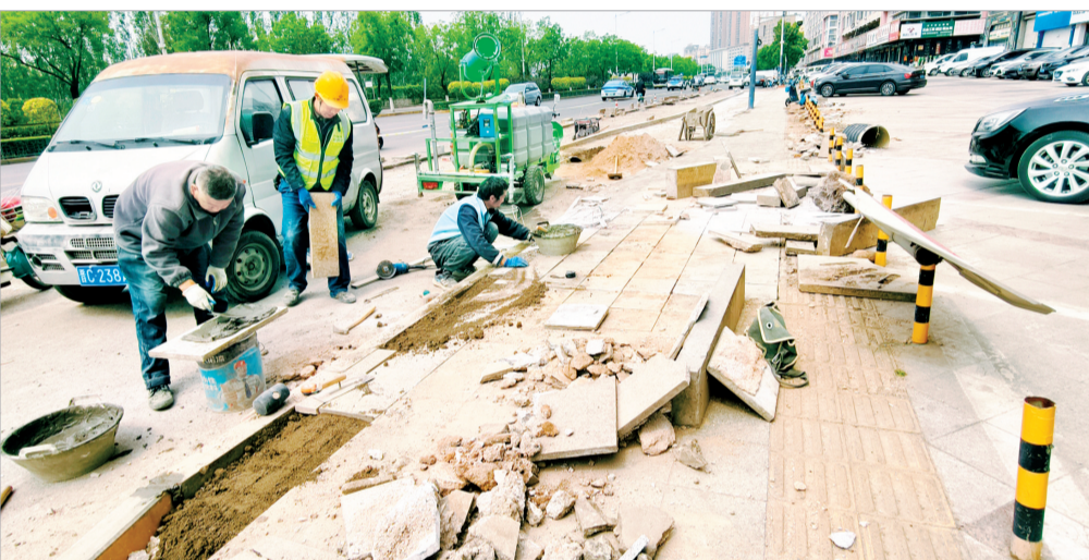
近段时间,我市正在对市区的12个公交站点进行港湾式改造,62个公交站点进行适老化无障碍改造。据了解,整个改造工程预计8月底完工。图为5月7日,施工人员正在对桃北东街上的一个公交站点进行港湾式改造。晋向华摄
